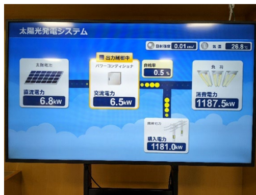
自家発電状況のモニタリングモニター
