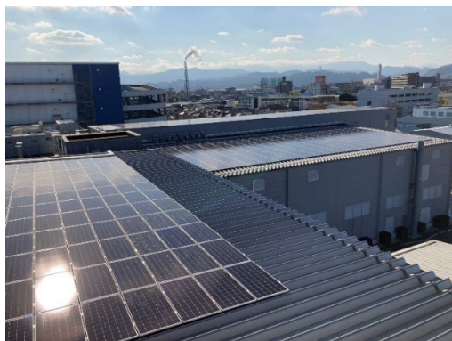
屋上に設置した太陽光パネル
